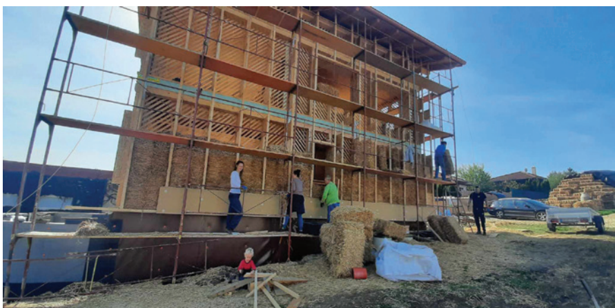
Obr. č. 3: Väčší rodinný dom postavený inovatívnou metódou. Drevená nosná konštrukcia umožňuje vloženie dvoch slamených balíkov „na kant“ tak, aby sa využilo priečne kladenie stebiel slamy pre ešte lepšiu tepelnú izoláciu, postačujúcu aj na pasívny štandard. Foto: Tomáš Karabinoš, projekt: Ateliér ARCHA
